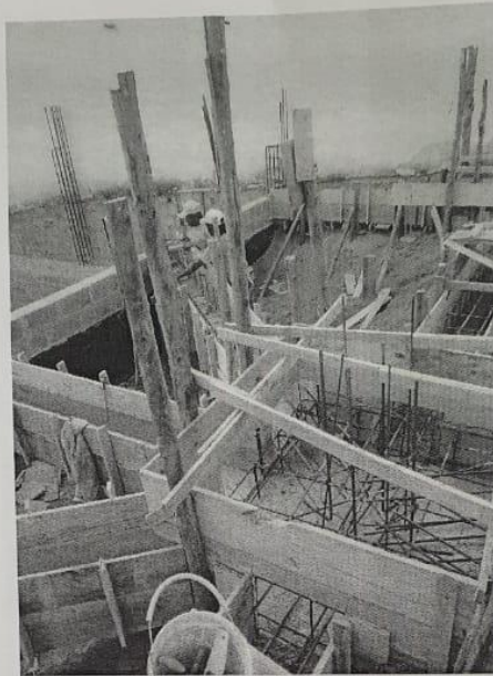
Foto 3 – forma e armação das vigas de fundação e equilíbrio da plenária, forma e armação dos blocos e arranques da fundação da plenária
